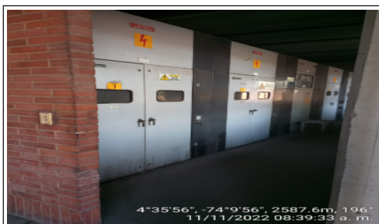
Fotografía 5. Ubicación tres (3) transformadores eléctricos
